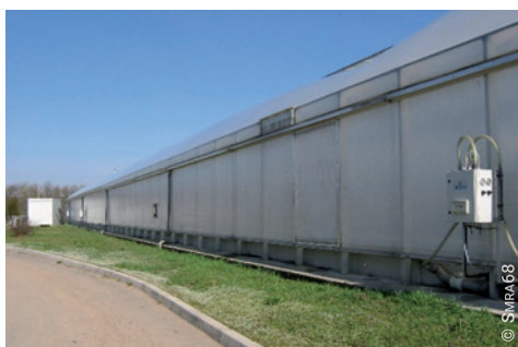
Serre de séchage solaire sans plancher chauffant (STEU d'Ensisheim – Haut-Rhin)
