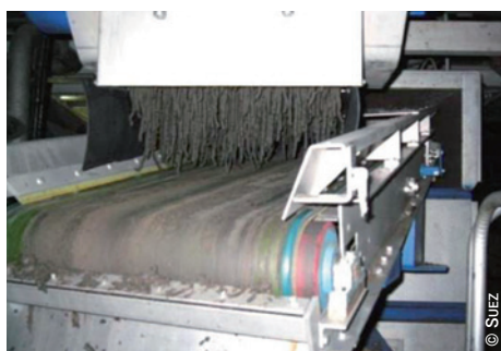
Mise en forme de boues par « spaghettiage » et alimentation du sécheur à bandes
